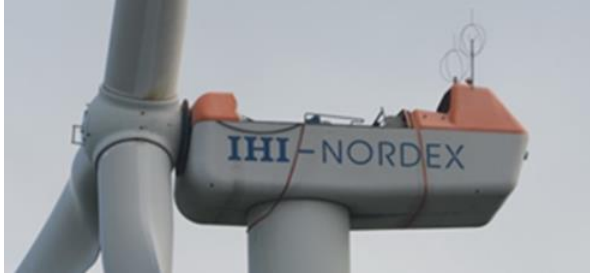
図 3 風車の被害状況
